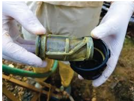
FIGURA 6 – FILTRO EM MAU ESTADO DE CONSERVAÇÃO
